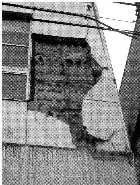
写真5-2 S造構面外CB帳壁の損傷例
