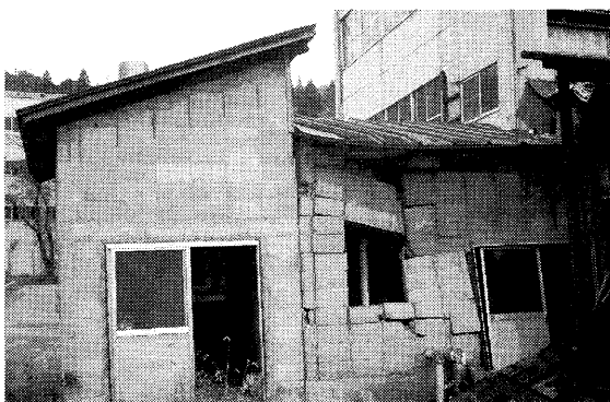
写真4-1 CB造崩壊例(小千谷)
