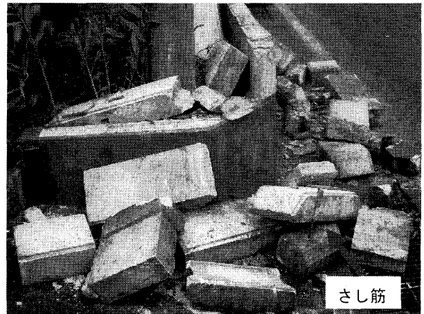
写真3-9 倒壊した組積造の塀(小千谷)
